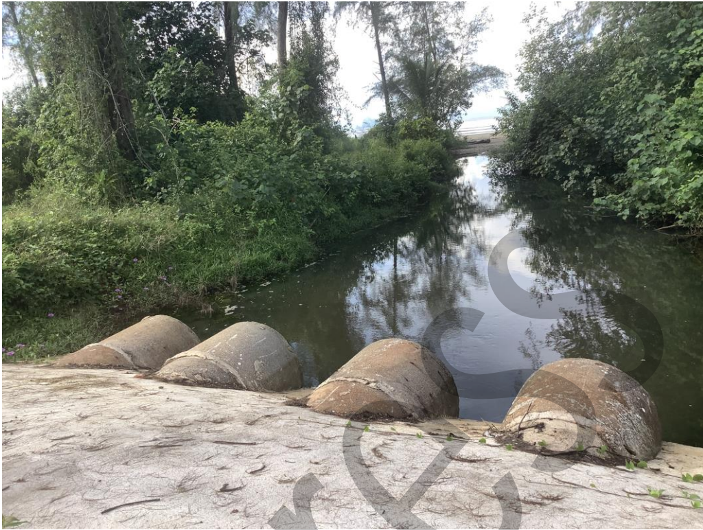
รูปที่ 6.1-13 ท่อลอดกลม ขนาด 4 ช่องบนช่วงของถนนท้องถิ่นที่ระบายน้ำลงสู่ทะเล บริเวณหาดสำราญ จ.ตรัง
